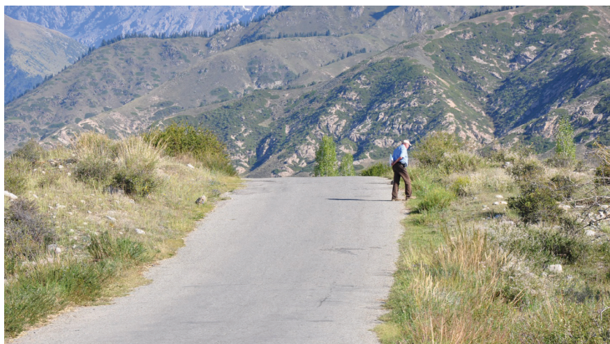
Рис. 4. Асфальтовое покрытие сельской дороги поднимается во фронте сейсмоуступа Кебинского землетрясения 1911 г. Евгений Александрович пытается понять: почему сейсмогенный разрыв внезапно заканчивается в нескольких метрах к востоку от дороги. На заднем плане южный склон хребта Терской Ала-Тоо
